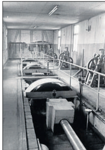
Das Innere des Turbinenhauses an der Neuen Mühle: Unser Foto zeigt eine Turbinenwelle mit Antrieb der Wasserschütze. Alle Antriebe stammen noch aus dem Jahr 1892.
