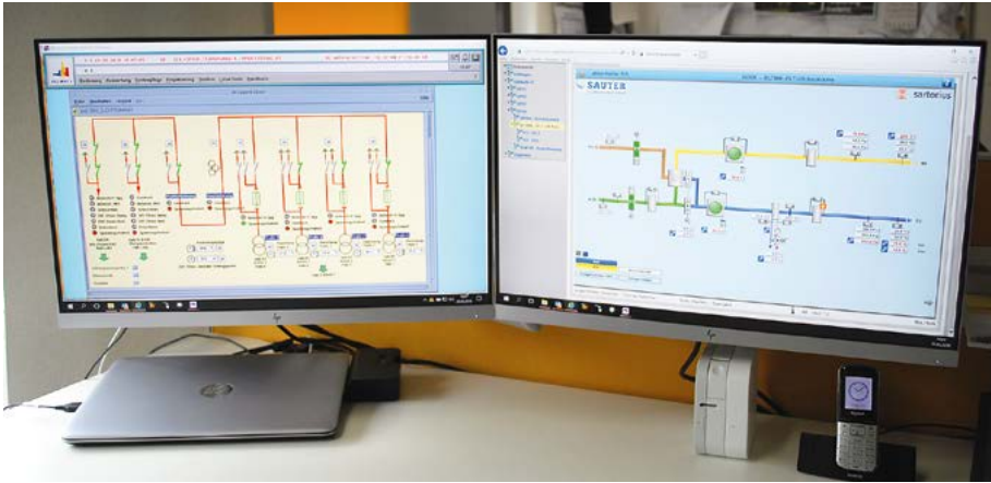
Zur Überwachung der Betriebsmittel und Anlagen bedient man sich moderner Leittechniksoftware.
