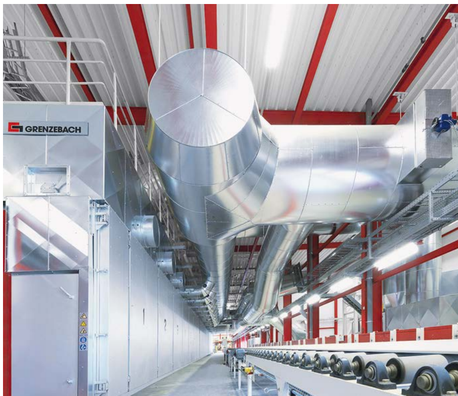
Bei den Grenzebach-Produktionsanlagen für die Gips-Industrie kommen auch Trockner mit Quer- oder Längsbelüftung zum Einsatz.
