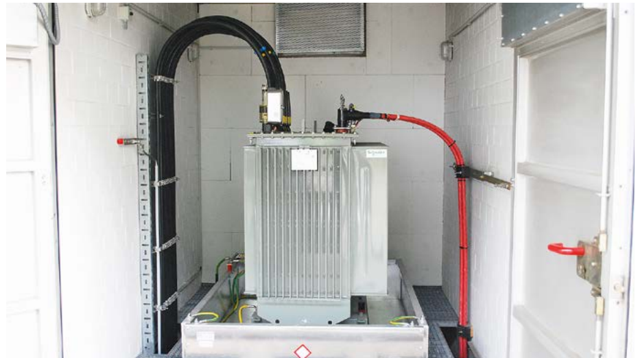
MS/NS Transformator zur Gewährung der eigenen Stromversorgung.
