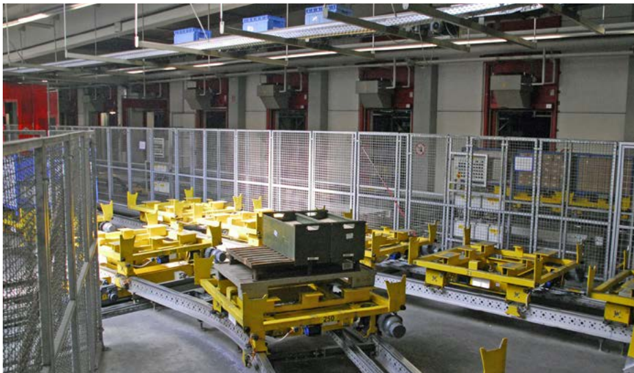
Die Elektropalettenbahn auf dem Weg zwischen Wareneingang und dem Hochregallager 1 (unten). Darüber die Fördertechnik der KLT-Anlage
